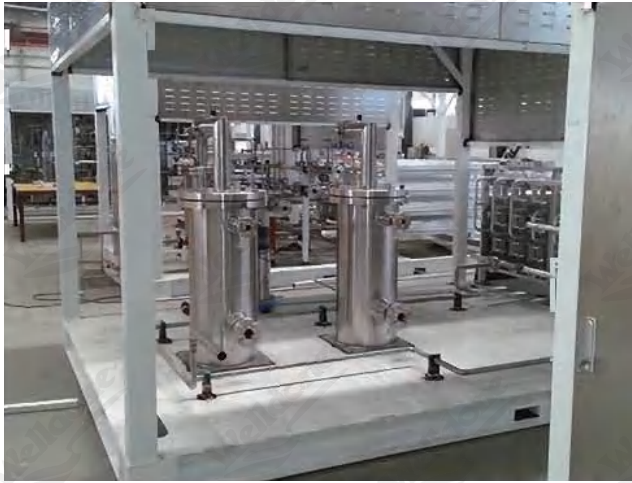
加液站用泵池
